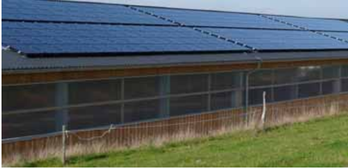
Eine Reithalle mit auf dem Dach montierter Photovoltaik-Anlage
